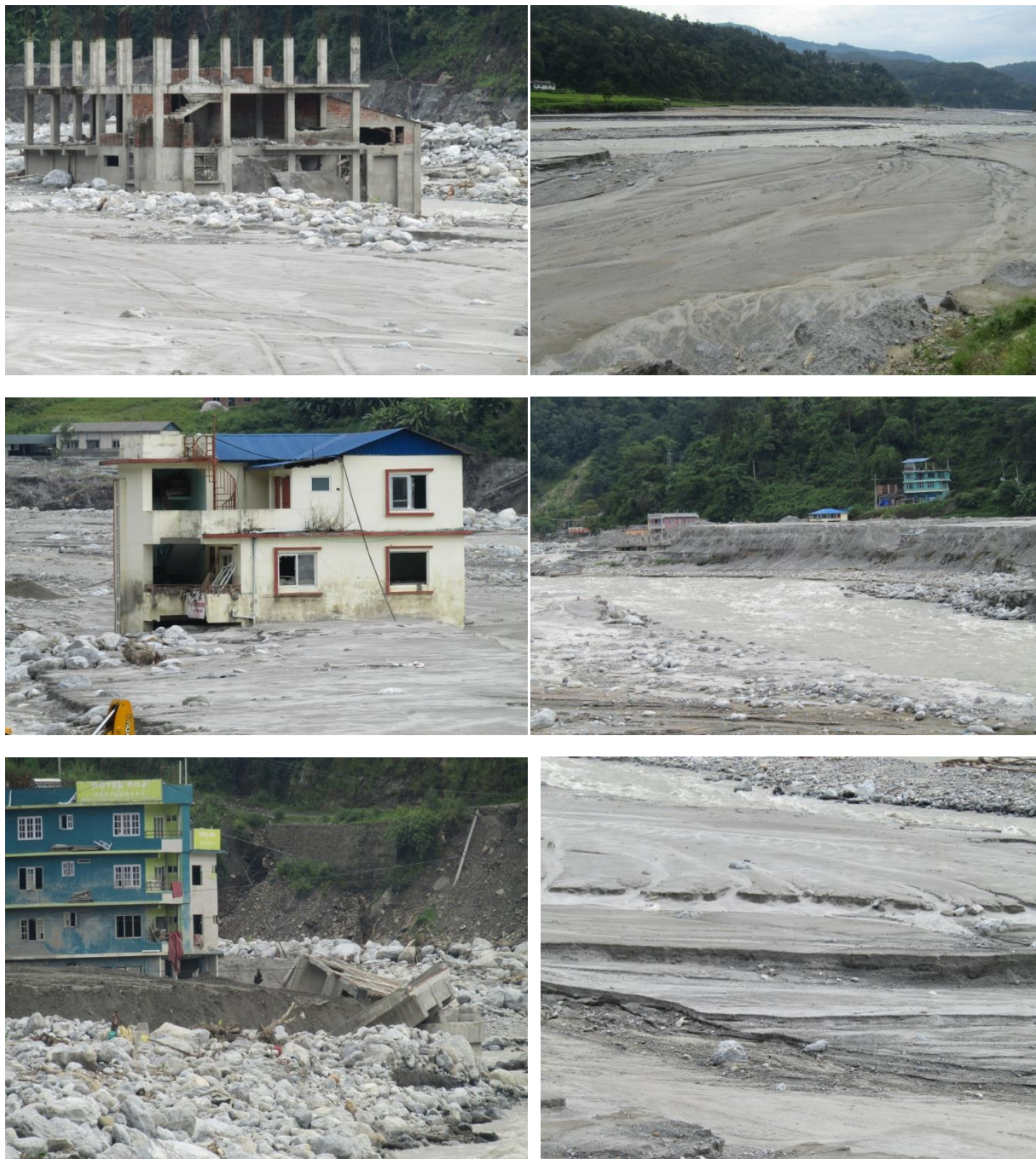
मेलम्ची नगरपालिकाबाट निर्माण गरिएका भौतिक संरचनाहरूको बाढी पछिको अवस्था
